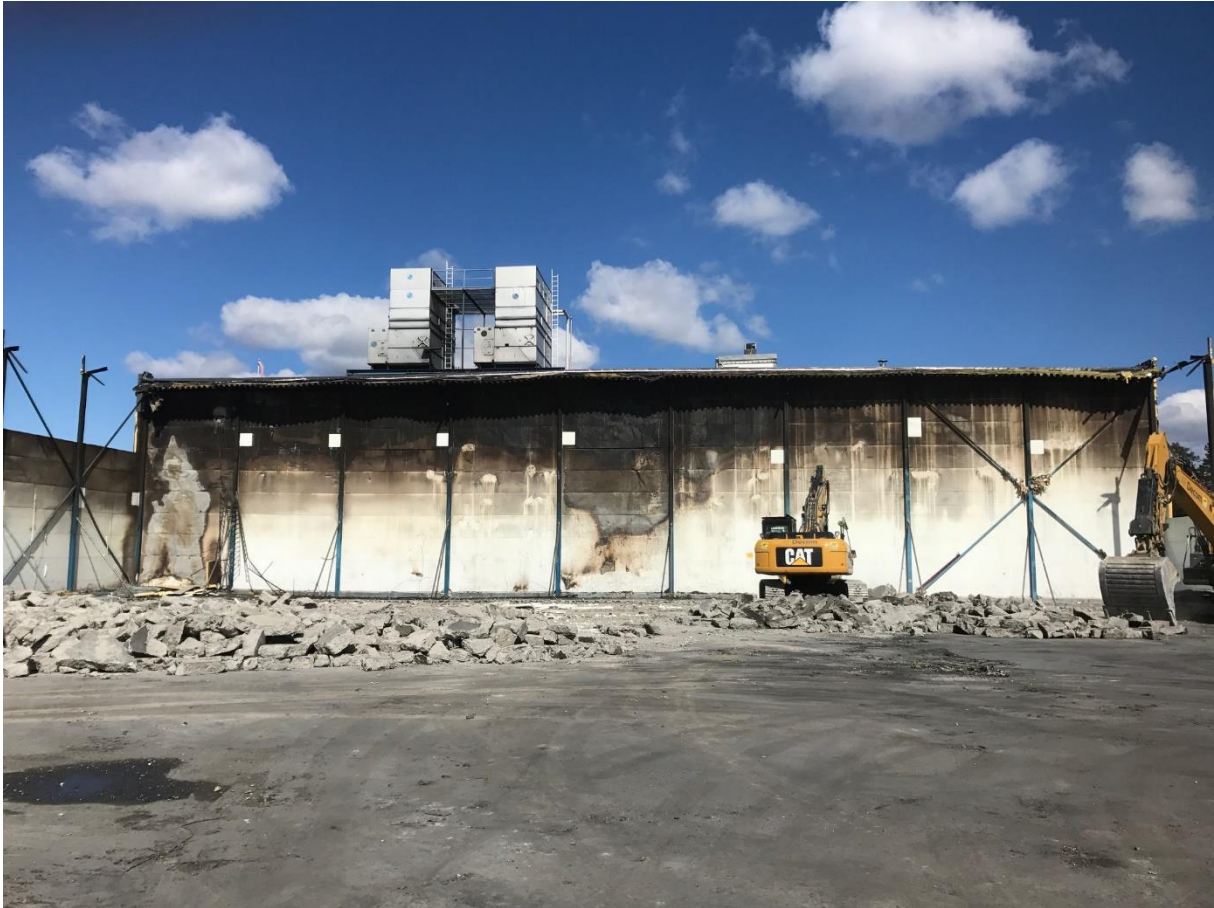
Figur 18: Brannskillet mellom fryselageret og det tekniske rommet (Bildet tatt 26/4)
