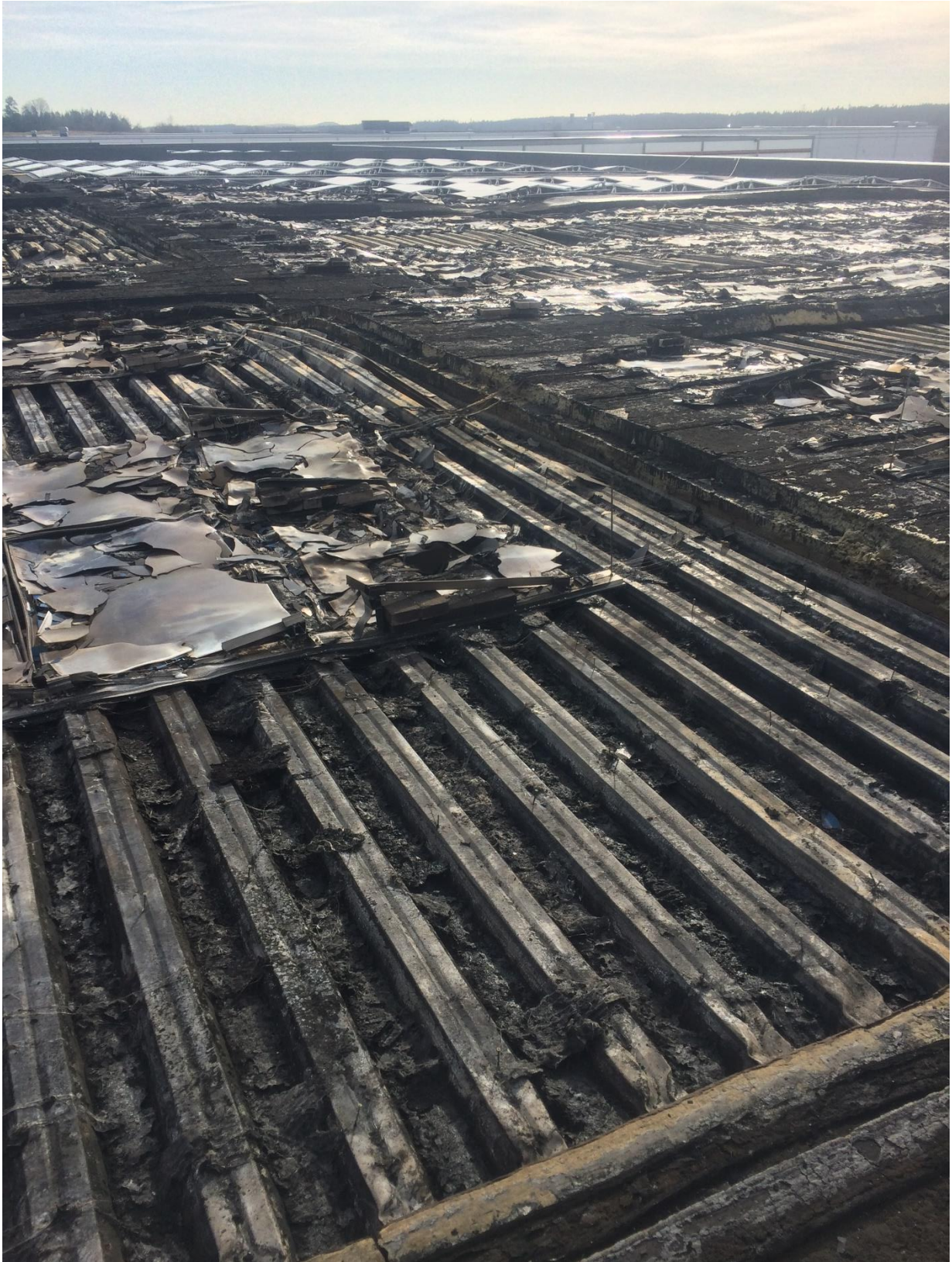
Figur 8: Taket (sett fra brannskillet og i sørvestlig retning), slik det så ut ettermiddagen 9/4 (fase 1)
